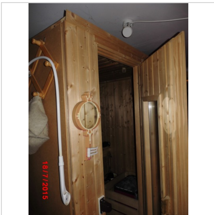
Sauna im Keller
